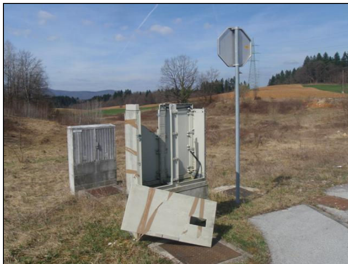
- uničene omarice kot posledica nedokončane soseske -
