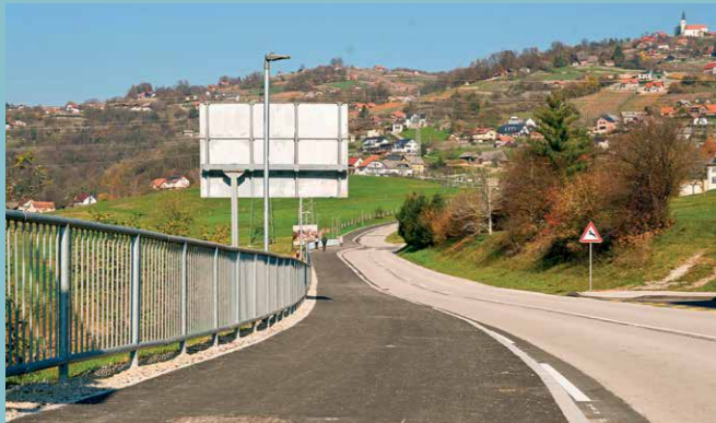
Zaključena je izgradnja kolesarske povezave med krožiščem »Pletenka« in Trško goro, ki povezuje obstoječe poti z izobraževalnim središčem in turističnim območjem ter izboljšuje varnost kolesarjev.
