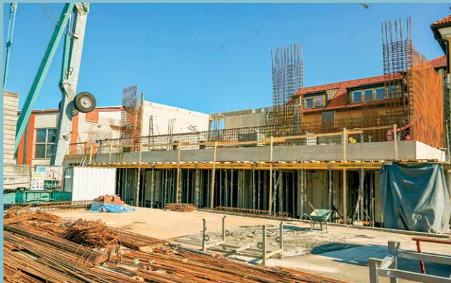
Na Osnovni šoli Šmilhel po načrtih poteka gradnja prizidka, ki bo zagotovil dodatne sodobne pogoje za delo in učenje.
