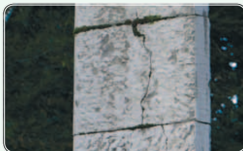
Poškodba kamnitega elementa stolpa spomenika NOB na Ruperč Vrhu
