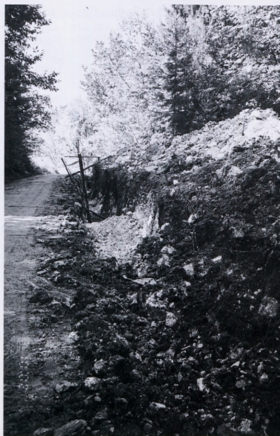
Po zelo težkem, skalnatem terenu so položeni prvi metri vodovodnih cevi na trasi t.i. vodovoda »MRAŠEVO«
